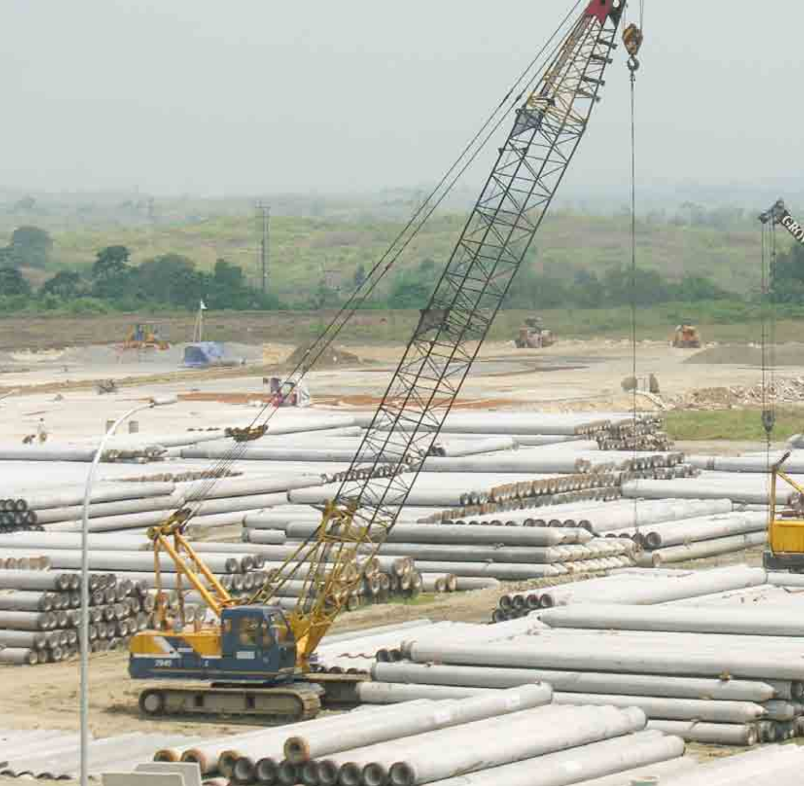
Proyek Pembangunan Pabrik Astra Honda Motor (AHM) - Jawa Barat Astra Honda Motor (AHM) Factory Construction Project - West Java
