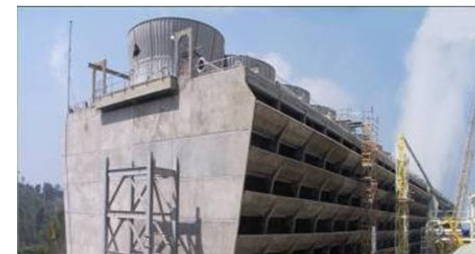
Pipe racks untuk perusahaan minyak, water storage dan water-cooling towers untuk pembangkit listrik
